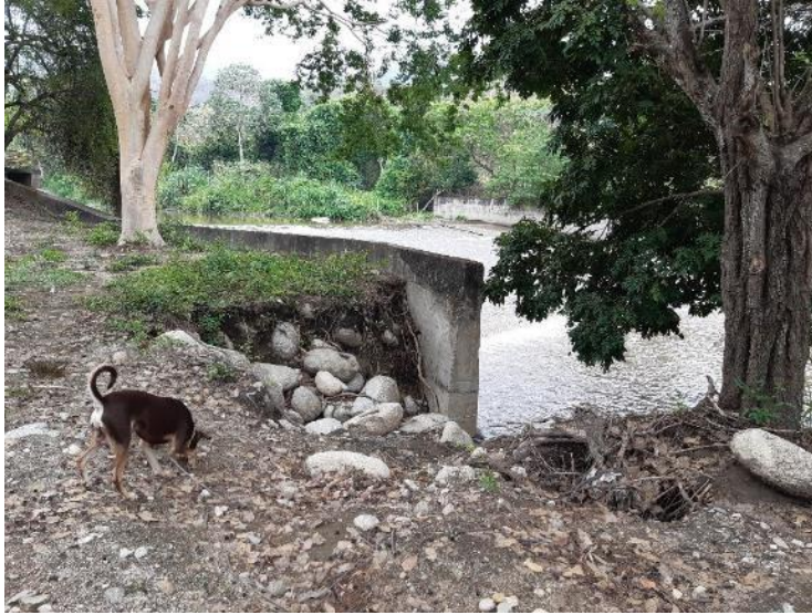
Figura 4-6 Daños en la ribera del Río Sevilla justo al sur de la toma principal de ASOSEVILLA, daños causados por la inundación de 2021. (imagen de Acacia Agua, abril de 2022).
